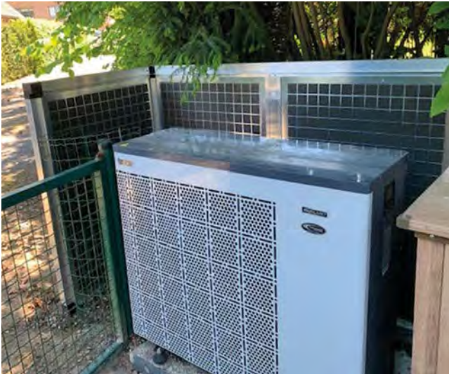
Schallschutzwand vor Wärmepumpe, Privathaus, München
