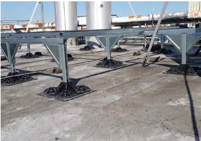
Aufstellort Flachdach einer Fleischerei
