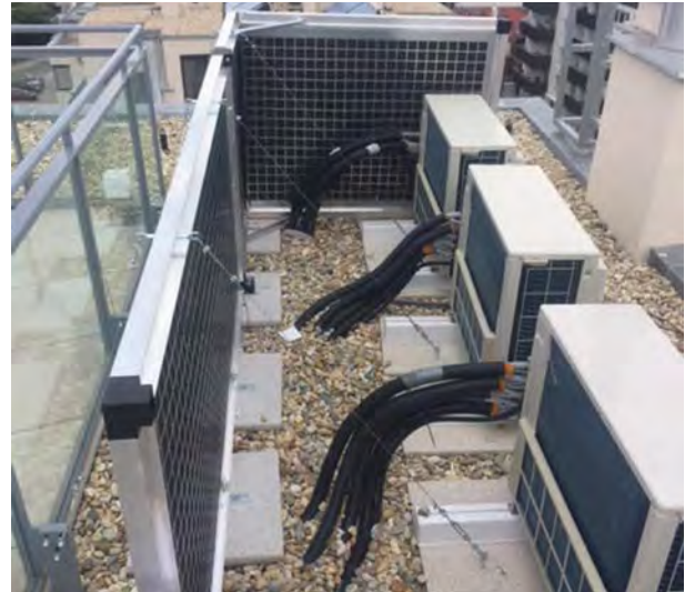
Schallschutzwand Mehrfamilienhaus, Wien
